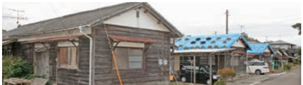
雨漏り心配、町営住宅
