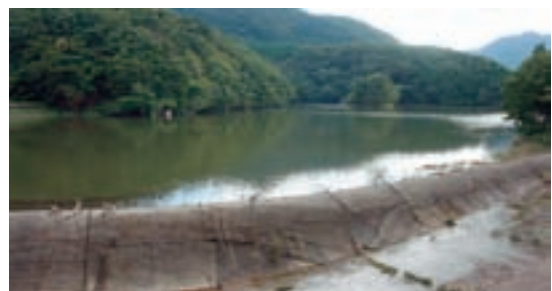
劣化が進むため池
