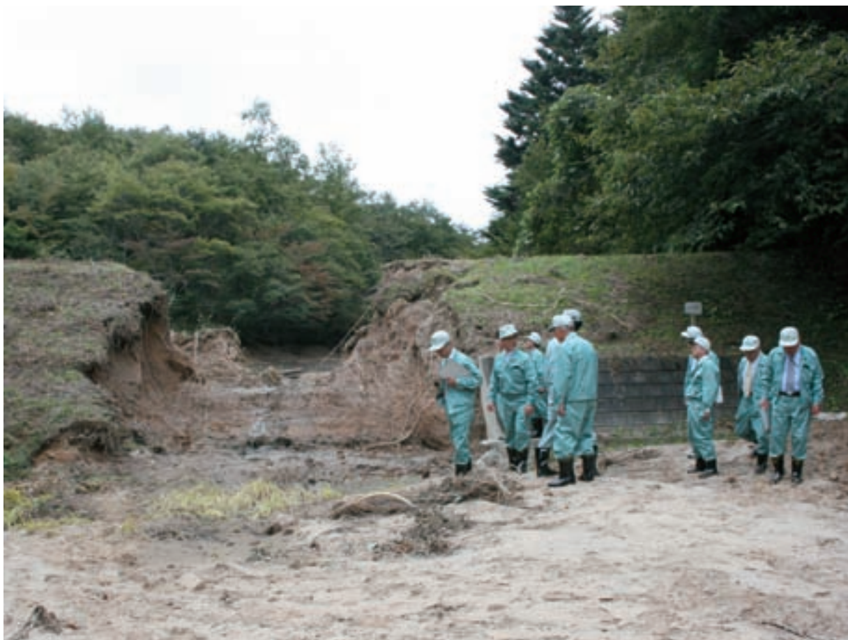
堤体が決壊した小谷沢ため池（幕柳地区）
