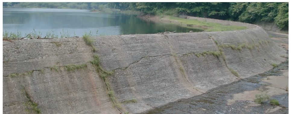
ひび割れ、水もれ、どうするの（嘉太神ダム）
