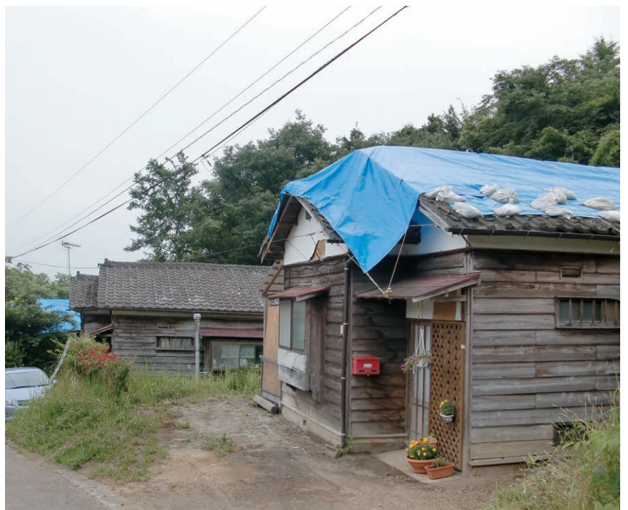
雨もりを防ぐブルーシート
