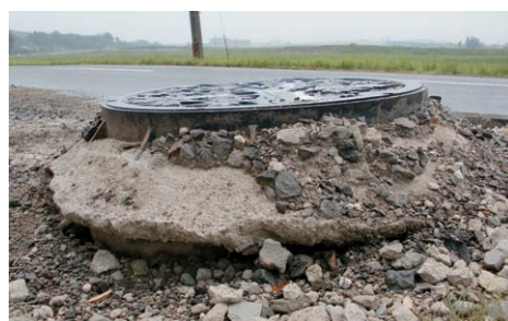
浮き上がったマンホール
