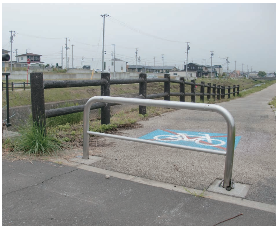
車イスが通れない 安全柵が切れている歩道
