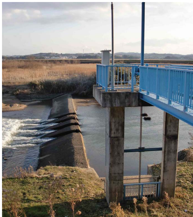
早期の改修が求められる粕川堰
