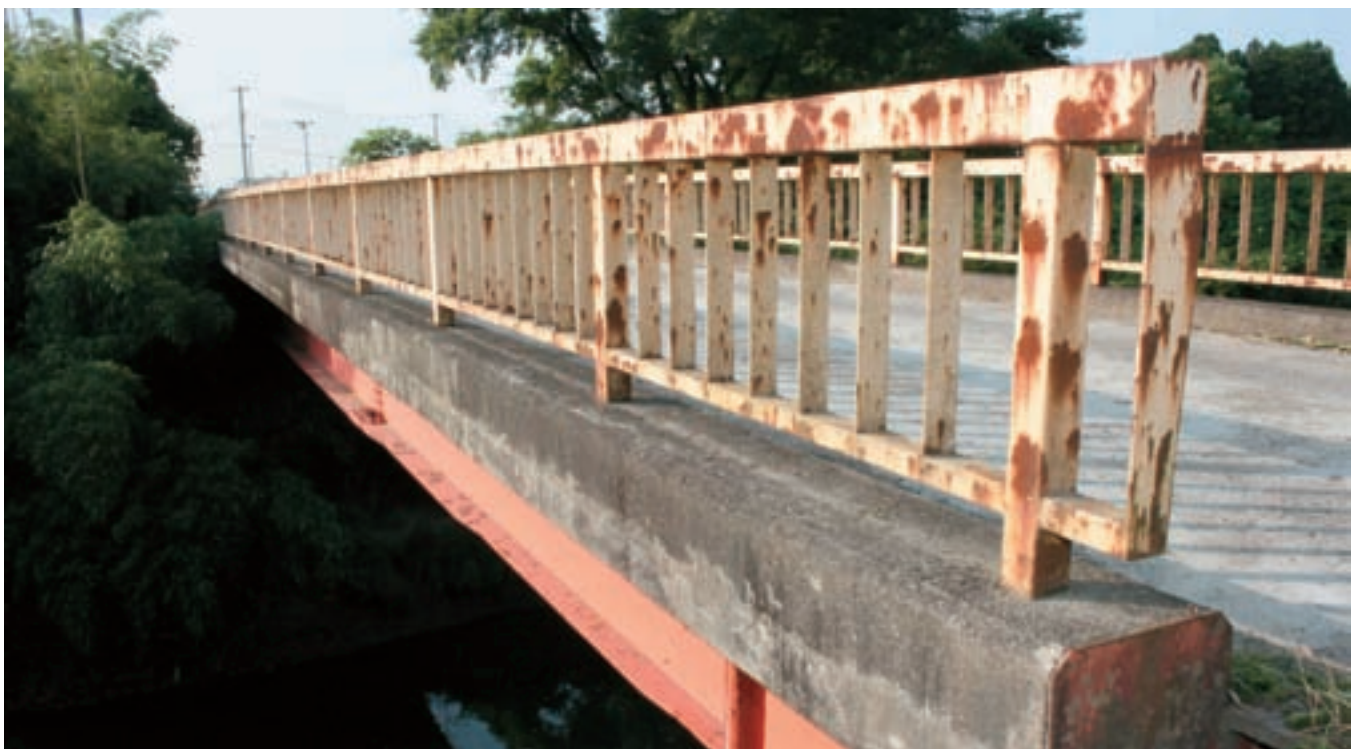
腐食が進む欄干
