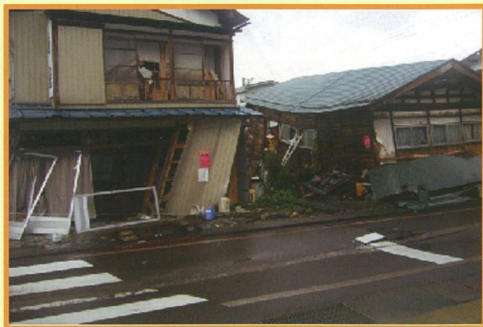
地震によって、全壊した建物
