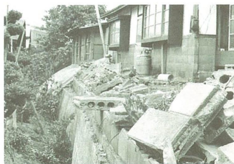
ブロック塀の倒壊
