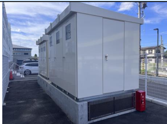
受電変電設備
