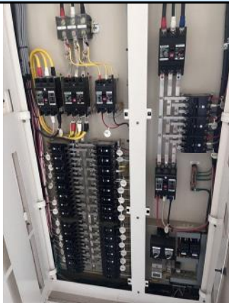
屋内分電盤 内観
