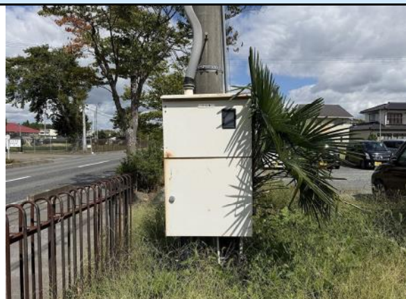
引込開閉器盤
