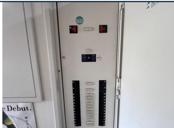
屋内配電盤 内観
