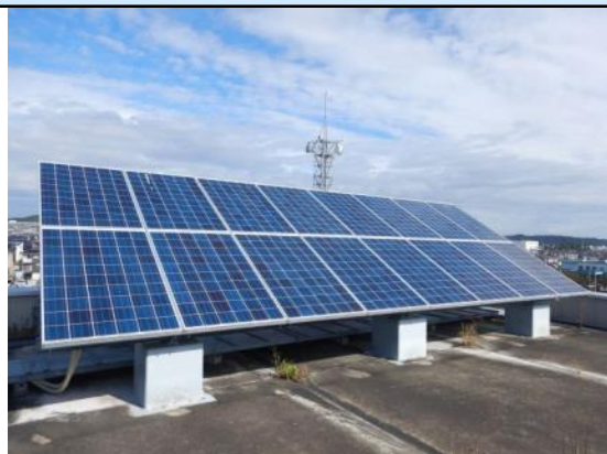
既設太陽光パネル
