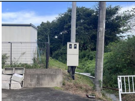
引込開閉器盤
