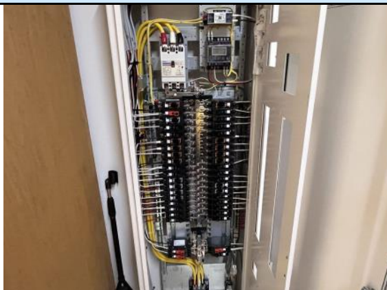
屋内配電盤 内観
