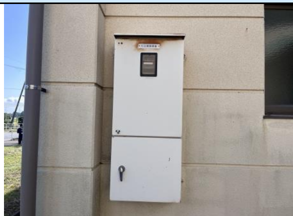
引込開閉器盤
