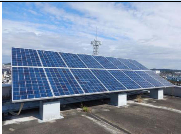
既設太陽光パネル
