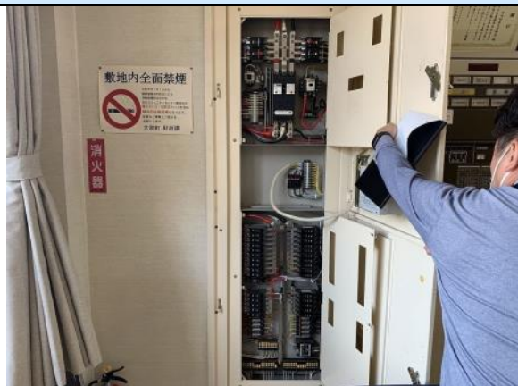
屋内分電盤 内観
