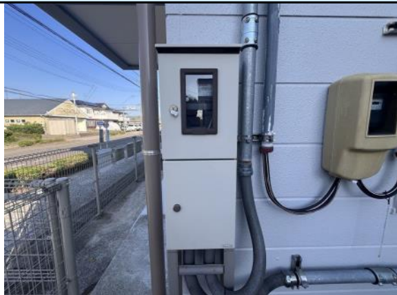
引込開閉器盤
